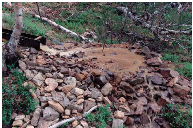
Jätekasa on rännin päässä, ja reunat korotetaan kivillä ja rakoihin lapioidaan ränninperän hiekka, jolloin liete jää padon keskelle.
