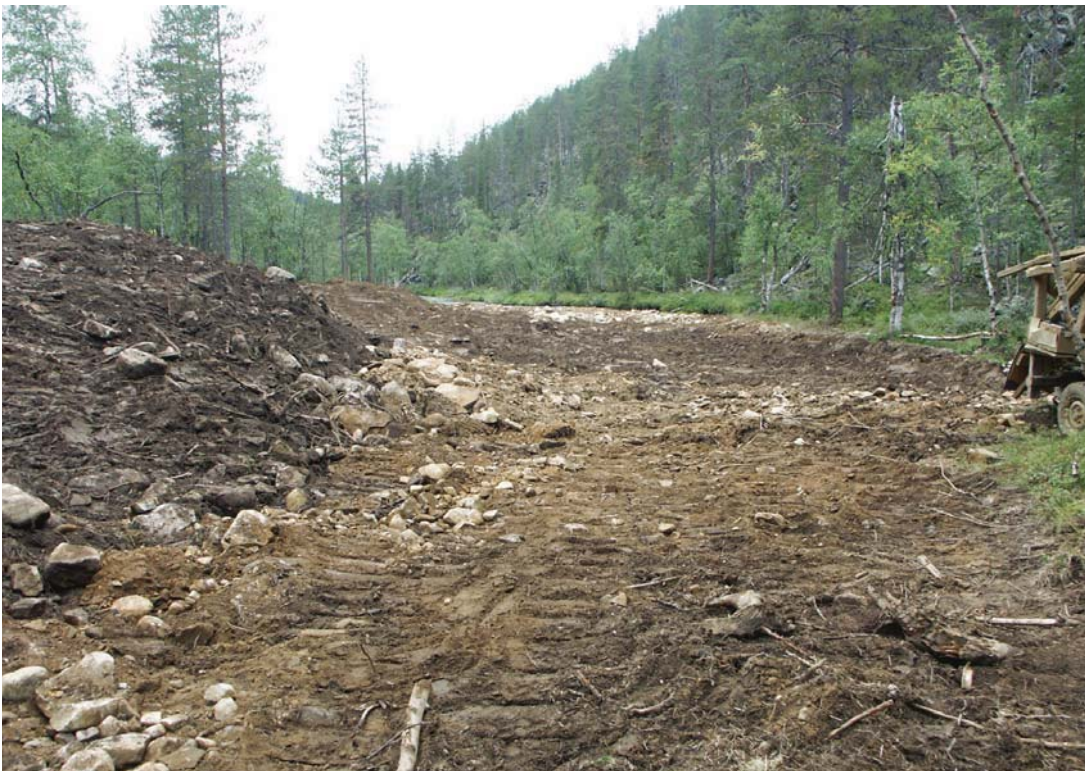
Konekaivajan maisemointijälkeä Palsilla. Muutaman vuoden kuluttua kasvusto peittää kaivujäljet. Kun kaivutyön aikana "säästetyt" pintamaat levitetään lopuksi, kasvit valtaavat nopeasti kaivukentän.
