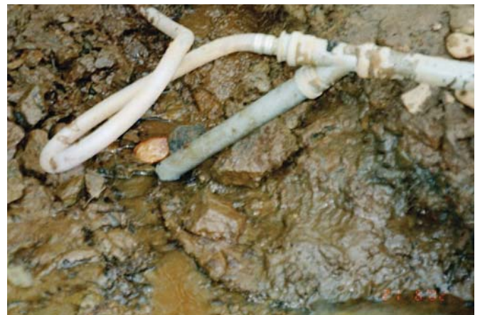
Viemäriputkesta tehty ejektor.
